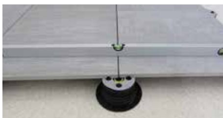
16. Verifique que el pavimento sea lineal.
